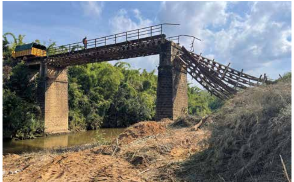
Abb. 47: Zerstörte Brücke auf der Zugangsstraße zum Projektgebiet des Bambuslemurenprojekts.
